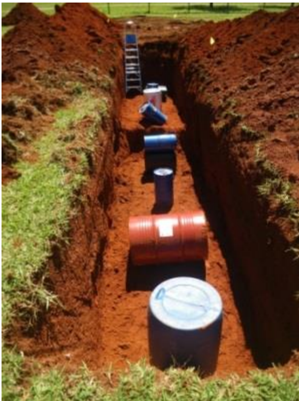
Figura 3 – Foto evidenciando os tambores metálicos e plásticos enterrados na área do SITCRIM.
